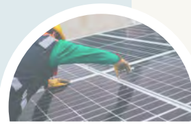
Energía solar fotovoltaica
