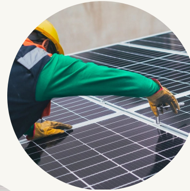
Energía solar fotovoltaica
